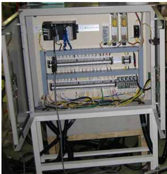
制御盤（内部） 「サイズ：600×700×160」
